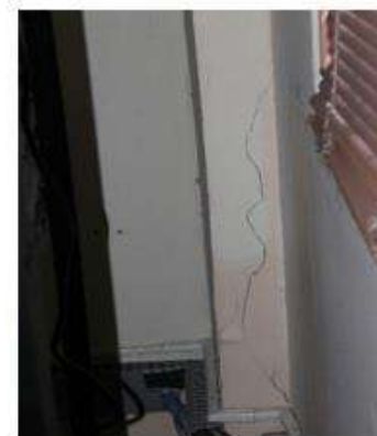
Levantamiento de daños, fisura vertical en columna
