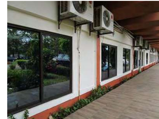
Instalación de ventanas en el Edificio de FISC en el Centro Regional de Chiriquí
