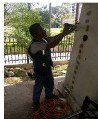
Mediciones de potencial de corrosión
