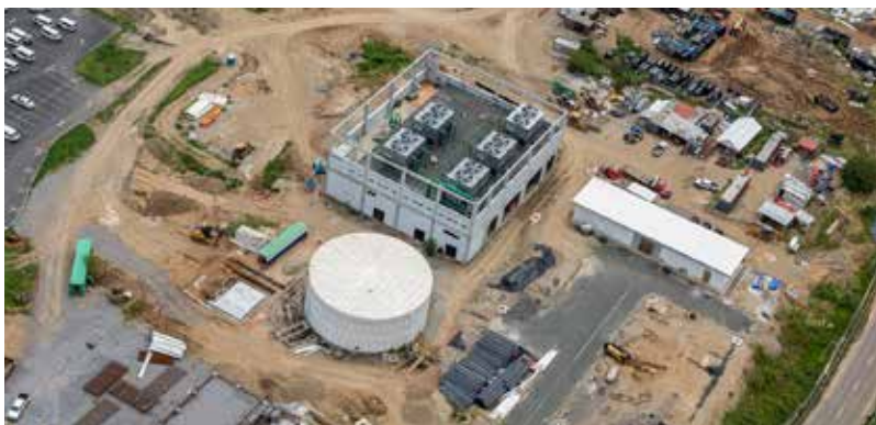
Vista de la planta de enfriamiento de agua y sub-estación eléctrica.
