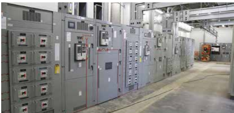
Infraestructura para el control de sistemas instalada en la Terminal 2.
