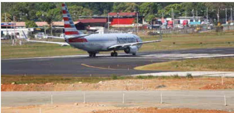
Vista de los trabajos de construcción de nuevo pavimento en calle de rodaje
