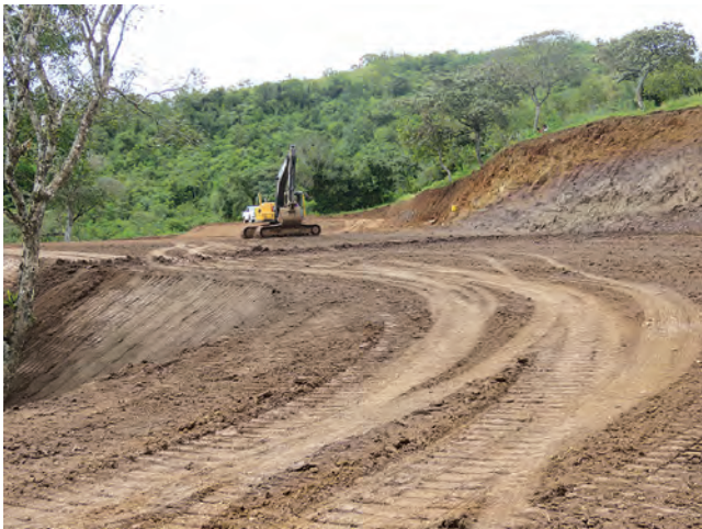
Inspección a Proyecto sin EsIA aprobado. Comarca Ngäbe Buglé.
