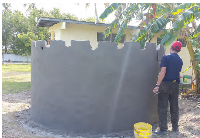
Construcción de tanques cisterna para sistema de captación de agua de lluvia.
