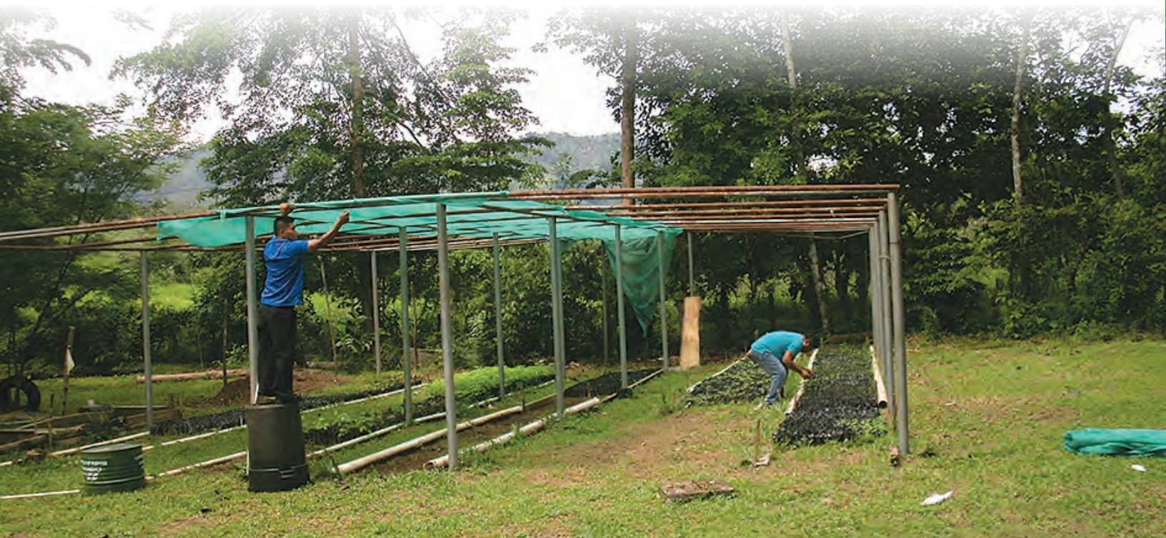
Rehabilitación de viveros y llenado de bolsa en la Sede Regional Comarca Ngäbe Buglé.
