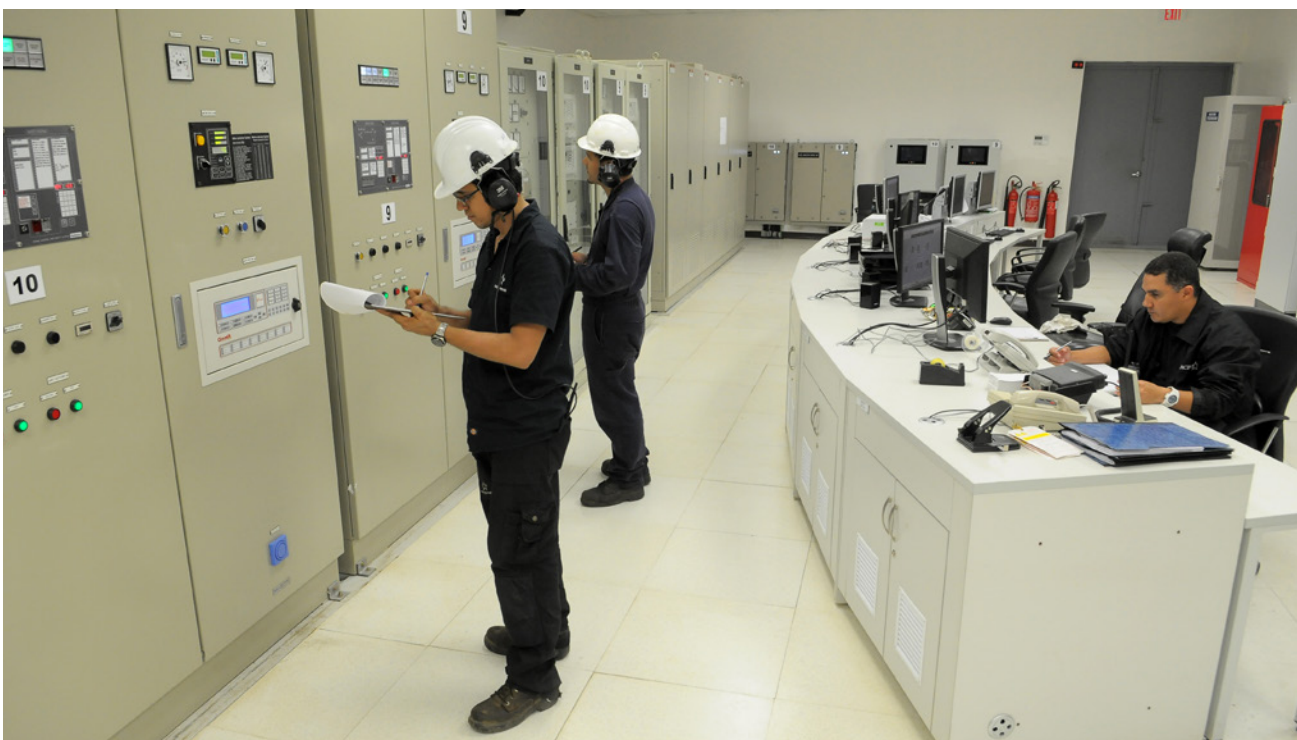
Operadores de las unidades de dos tiempos, planta de generación eléctrica de Miraflores
