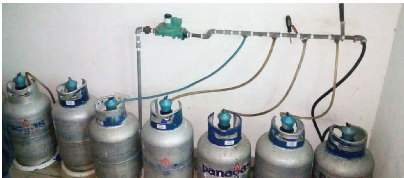
Tanques de gas de 25 libras, usados inadecuadamente en una lavandería de la ciudad de Colón
