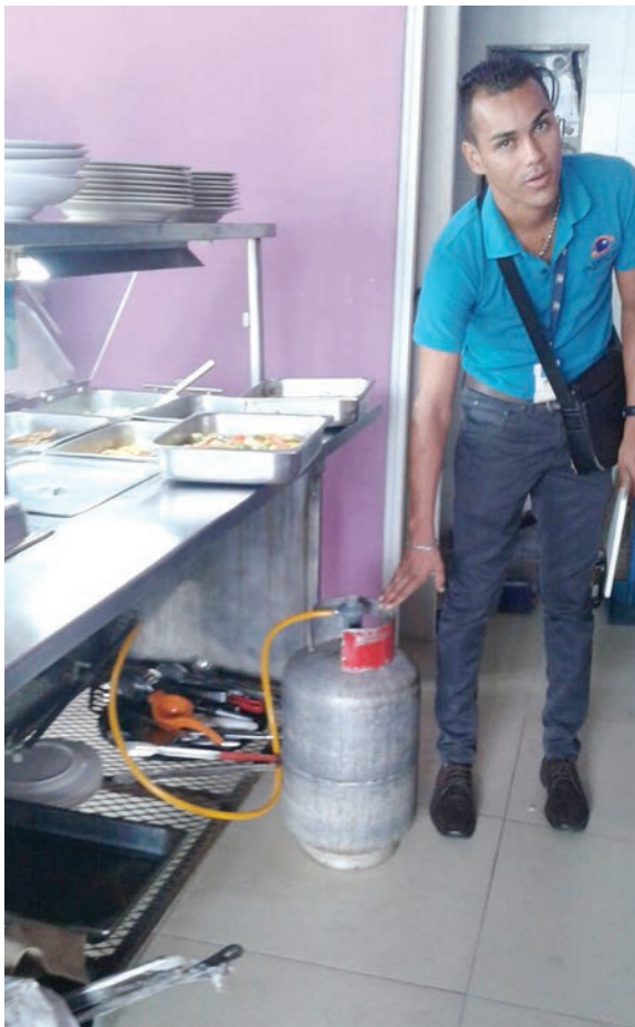
Verificación del cumplimiento al Decreto del uso de Tanques de Gas 25 lbs.
