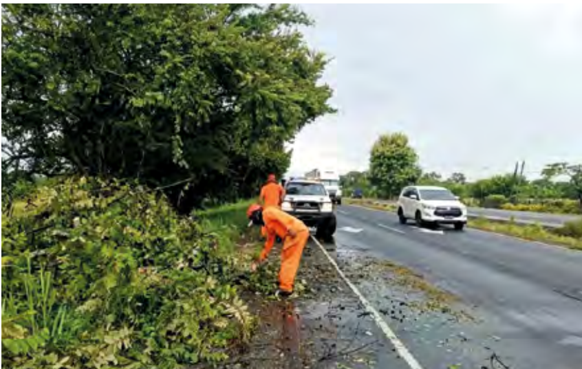
Atención por caída de árboles.
