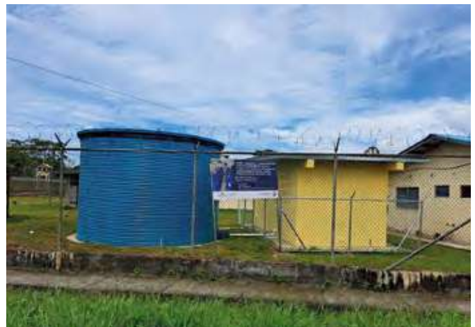
Planta de tratamiento de aguas residuales en Centro Penitenciario de Bocas del Toro.
