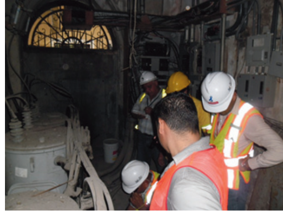
Cuarto eléctrico de Presidencia
