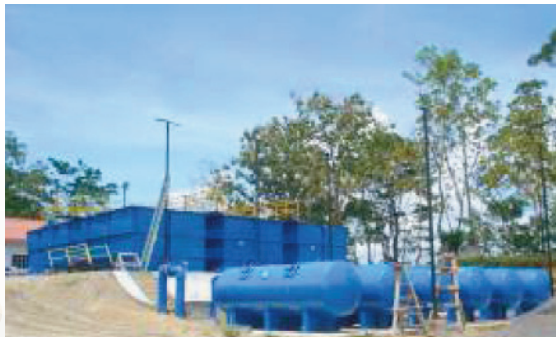
Vistas de los Filtros de la Planta
