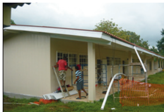
Construcción de 6 Aulas en el Jacobo Urriola. Portobelo, provincia de Colón. Convenio MEDUCA - PAN
