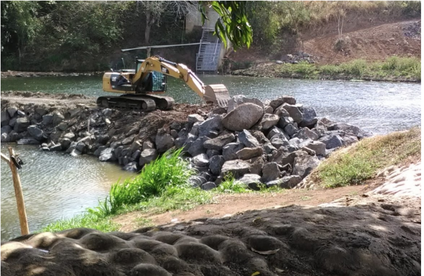
Trabajos de rehabilitación de presa fusible en la Toma de Agua Cruda de la Planta Potabilizadora Rufina Alfaro.
