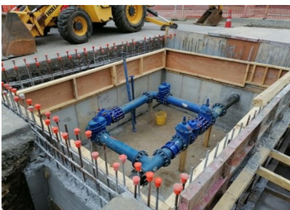
Caja de interconexión No.4 en calle 74 San Francisco.
