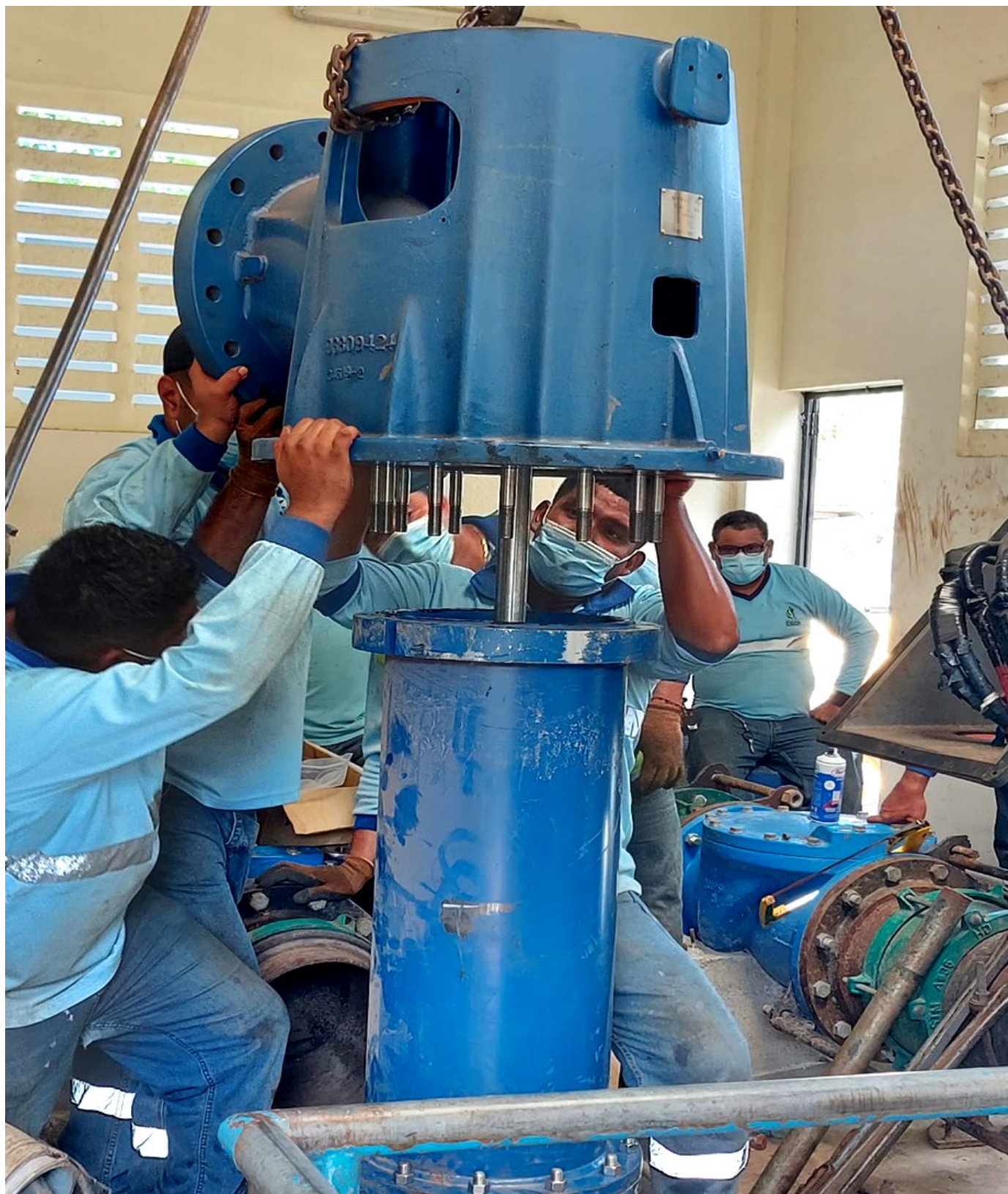
Instalación de las bombas tipo turbina vertical de la toma de agua cruda de Chame.
