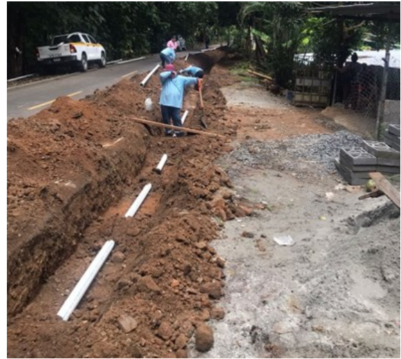
Mejora a Red de Distribución.
