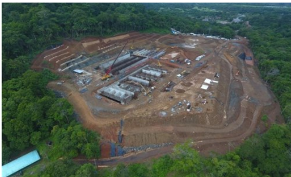
Avance del Proyecto PTAP Gamboa
