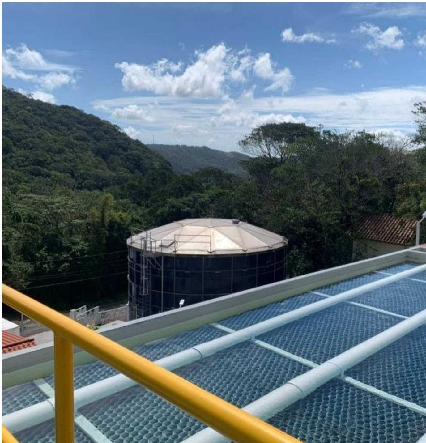
Planta de tratamiento de agua potable del nuevo acueducto del Valle de Antón.
