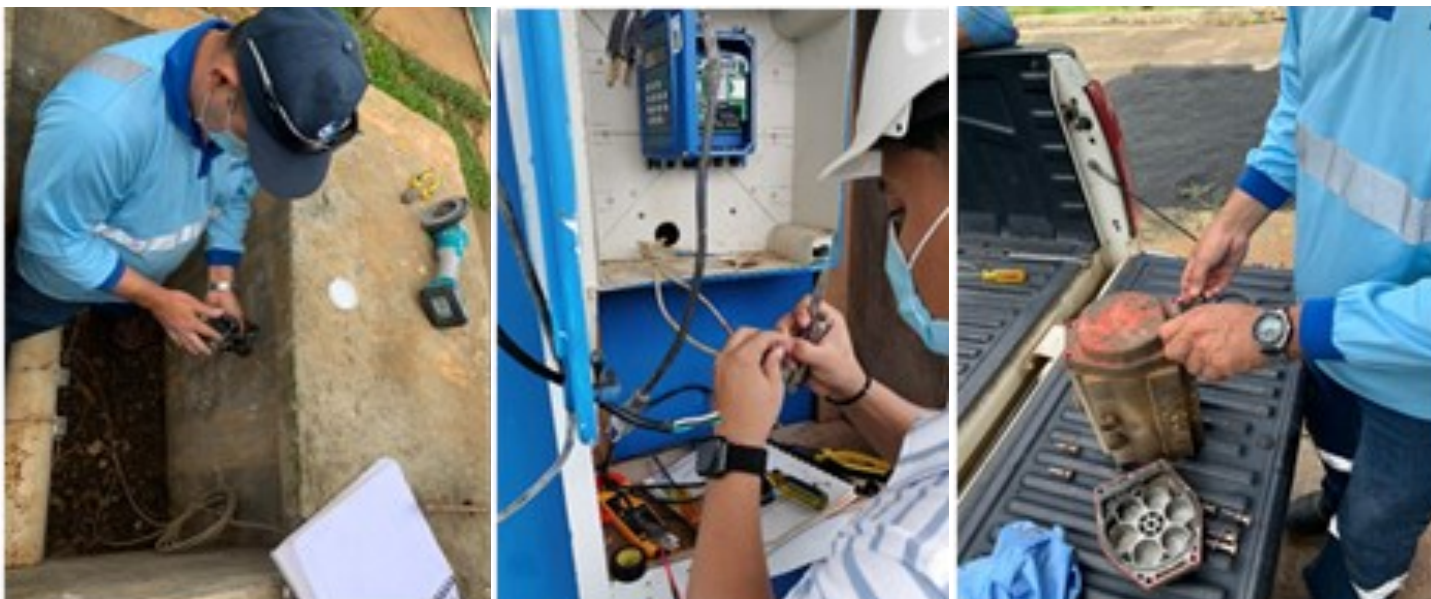
Personal de electromecánica brinda mantenimiento a los macro medidores y equipos de laboratorio y plantas potabilizadoras.
