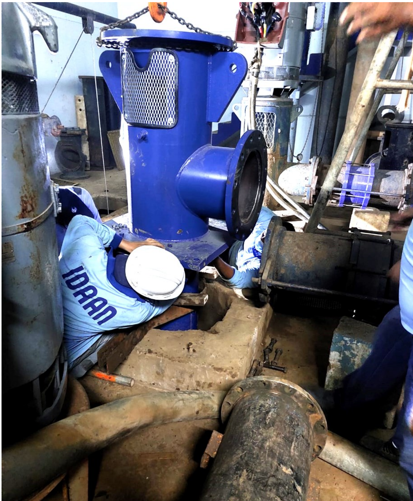
Instalación de bombas tipo turbina vertical de la Toma de Agua Cruda de La Chorrera.
