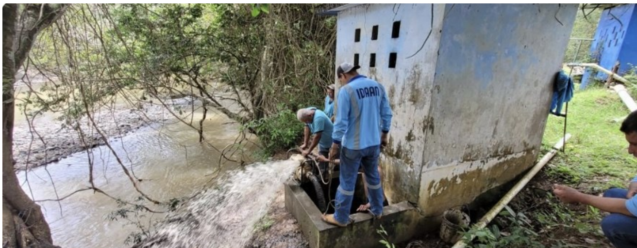
Instalación de equipo de bombeo para limpieza de fosa de succión de agua cruda de la Planta Potabilizadora de Macaracas.
