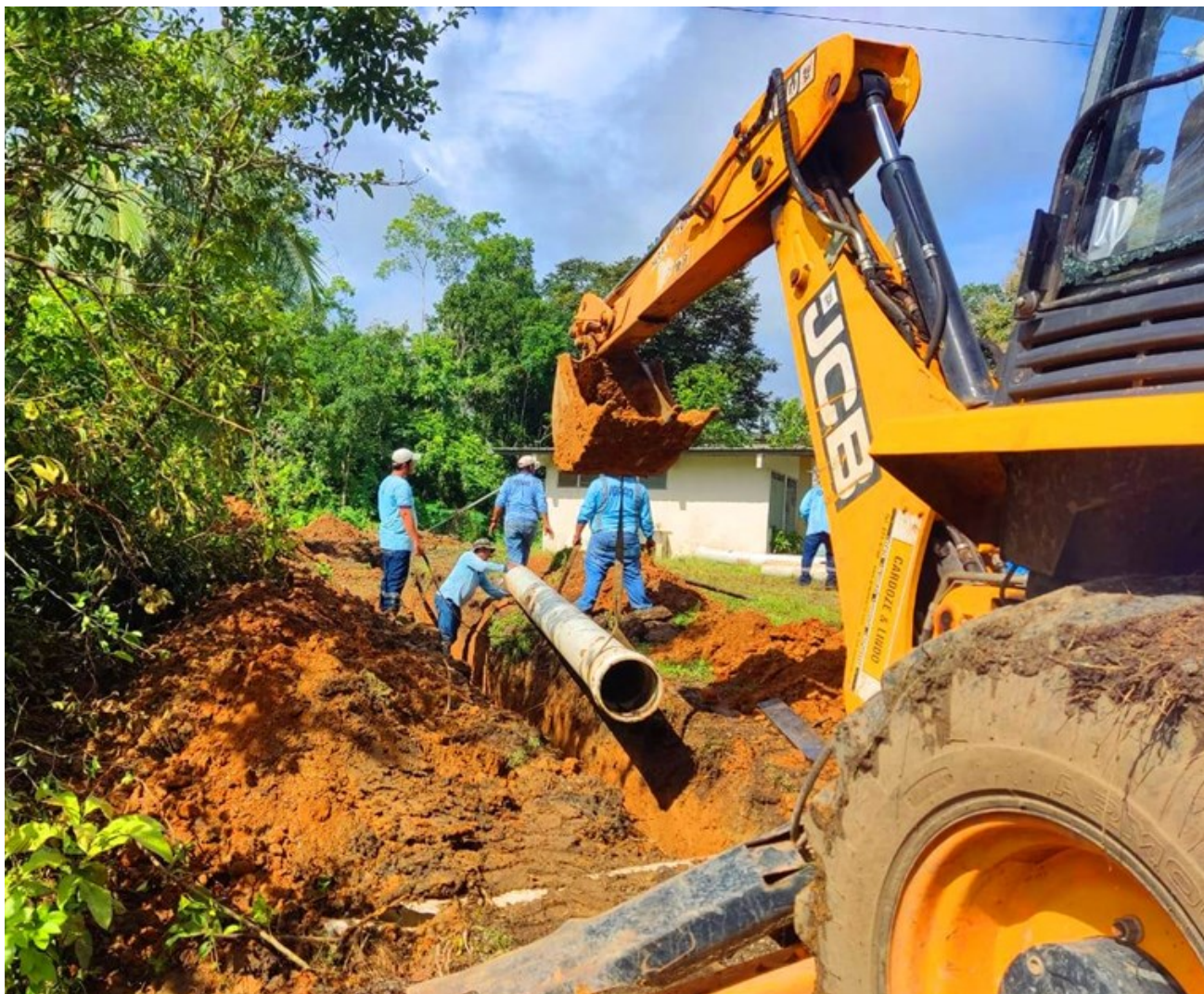
Trabajos de mejoras en el sistema de conducción de la Planta Potabilizadora de San Bartolo, Barú.
