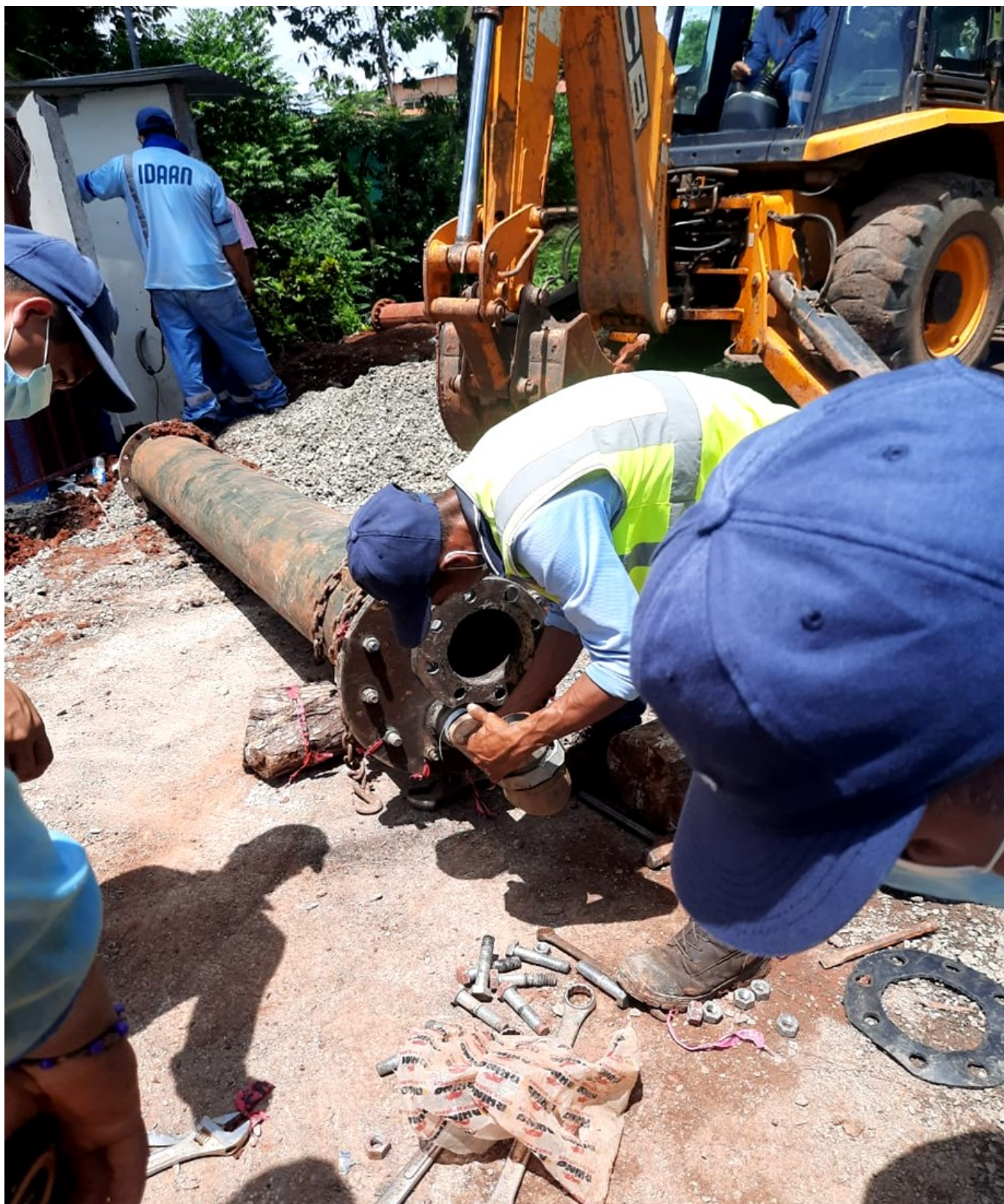
Rehabilitación de Estación de bombeo de Bianchery con mejoras al suministro de agua potable en Chorrillos 3, Santa Librada y parte de Sector Amaya en el Corregimiento El Coco, Distrito de La Chorrera.
