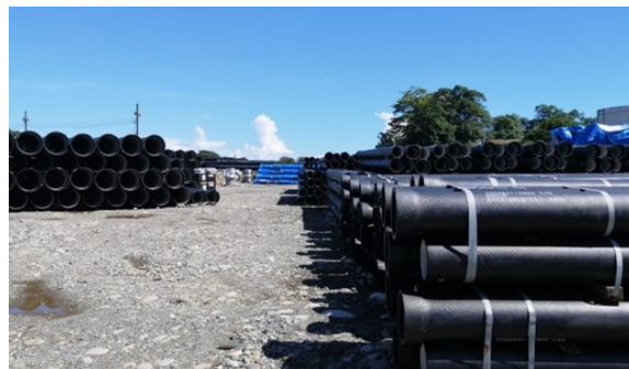
Tuberías de HD y accesorios, PTAP Chiriquí Grande
