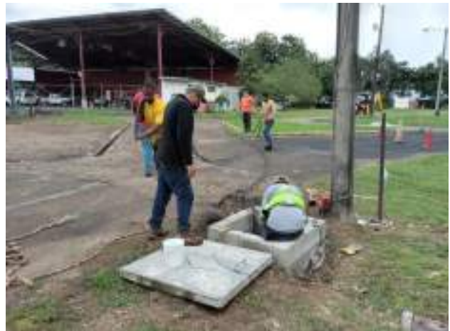
Alimentación eléctrica para laboratorio de Plaguicidas del CEI.
