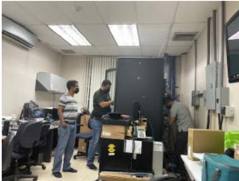
Adquisición e instalación de hardware, software y licencias para el reemplazo de la infraestructura del firewall perimetral de la red UTP.
