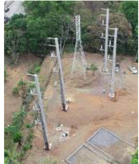
Trabajos de reubicación física de las Líneas de 115,000 Voltios de los Circuitos de Alta Tensión en el Campus Central Dr. Víctor Levi Sasso.
