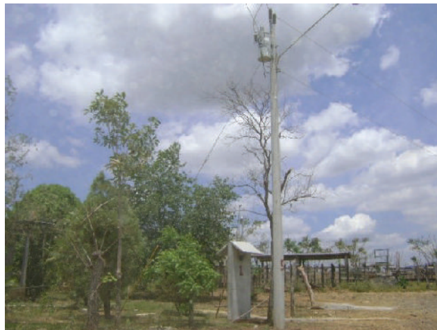
Línea de distribución eléctrica y tapia en la Comunidad del Jobero.
