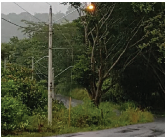
Línea de distribución eléctrica - Comunidad de Loma Grande.
