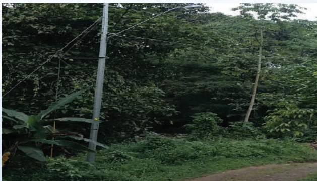
Línea de distribución eléctrica - Comunidad de San Miguel.
