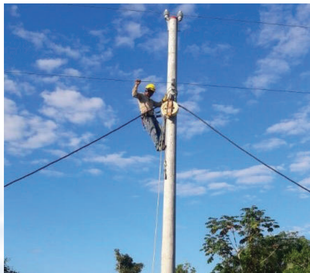
Línea de distribución eléctrica - Comunidad 4 de abril.
