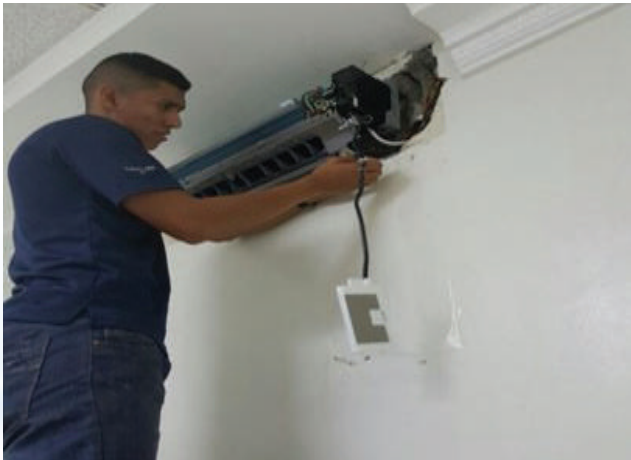
Mantenimiento de las instalaciones del SPI
