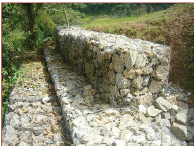
Construcción del muro de gaviones en el Parque Nacional Santa Fe, Veraguas.
