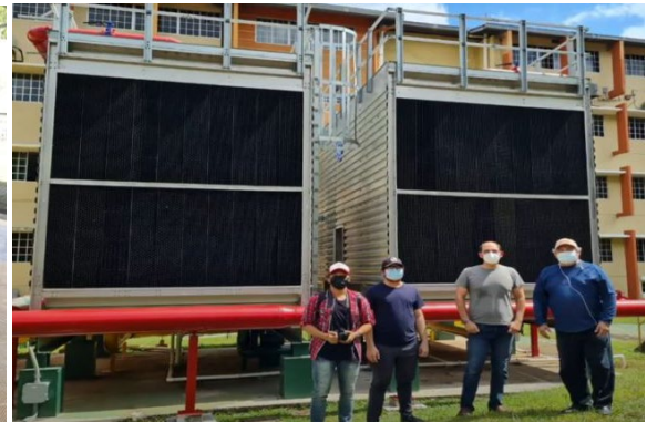
Grupo Estudiantil – ASHARAE Canalero – Campus realiza gira por la casa de máquinas del nuevo sistema de aire acondicionado del Edificio No. 1.
