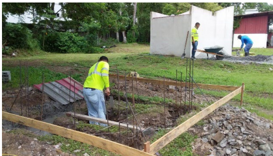
Construcción de caseta para para instalar acelerógrafo en la Extensión de Tocumen.
