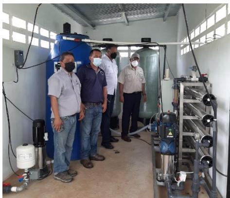
Inspección técnica al acueducto en Los Higos de Macaracas, provincia de Los Santos.
