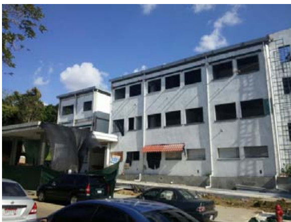
Vista del avance en la construcción del Edificio de la Dirección General de Tecnología de la Información y Comunicaciones (DITIC), en el Campus Dr. Víctor Levi Sasso
