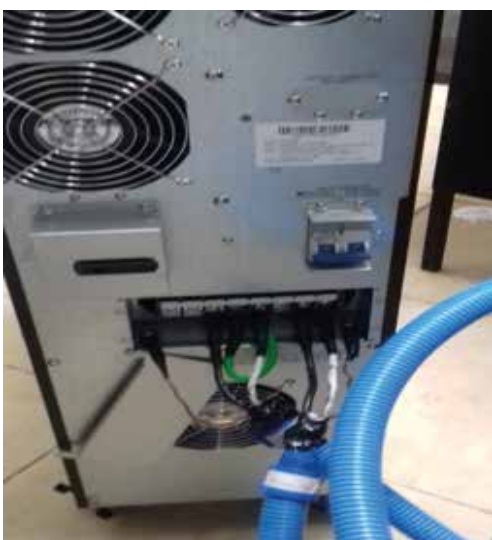
Instalación de Regulador de Voltaje
