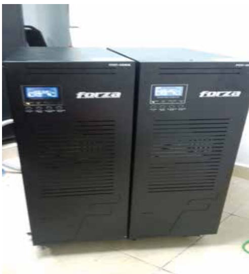
Reguladores de Voltaje
