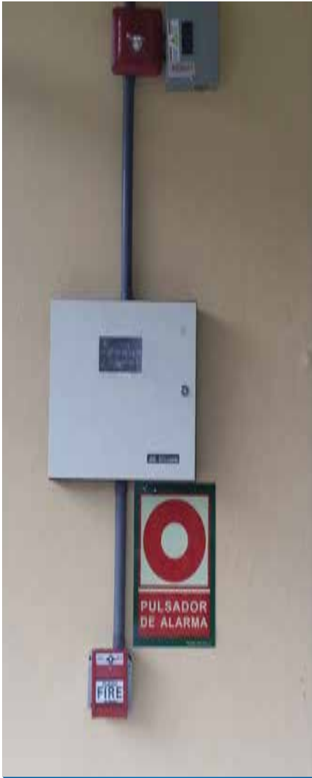
SISTEMA DE ALARMA CONTRA INCENDIO
