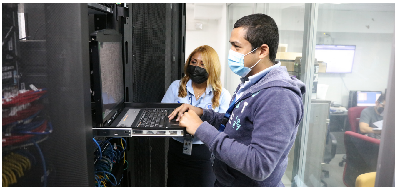
Equipo de Informática monitoreando los equipos de la institución.
