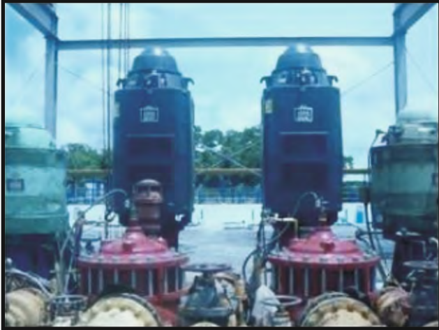
BOMBAS PARA LA PLANTA POTABILIZADORA DE SANTIAGO DE VERAGUAS
