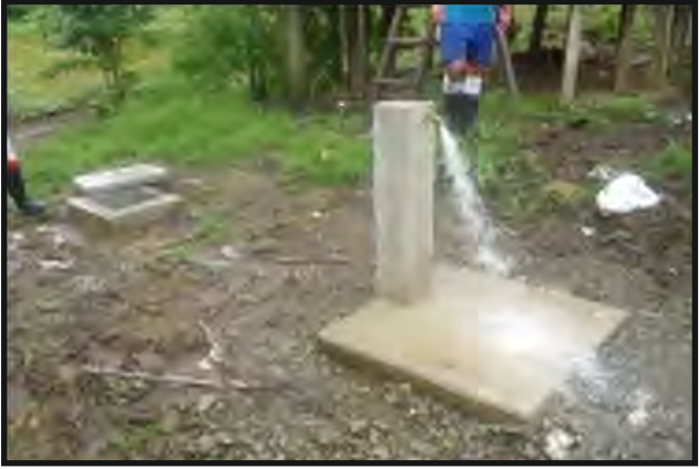
Construcción de Acueducto en la Comunidad de Peña Blanca Santa Fé, Corregimiento Calovebora B/. 33,906.60
