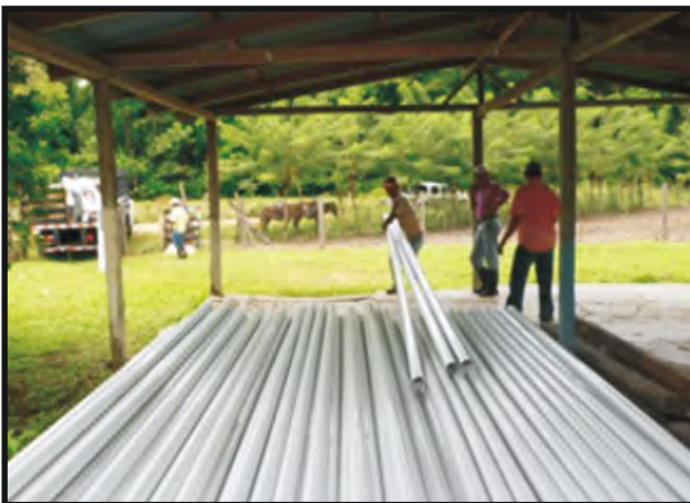
Entrega de materiales para acueductos rurales para ser construidos o reparados por las mismas comunidades.
