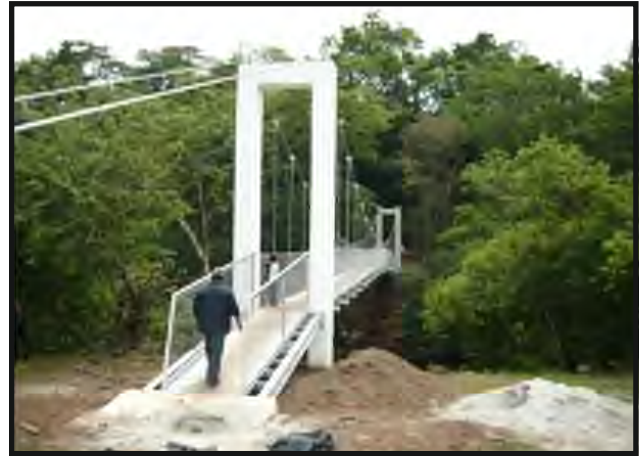
“Construcción de Puente Zarzo sobre Río Vigúin”, Las Palmas, Vigú, Comunidad El Macanito B/.119,999.25.
