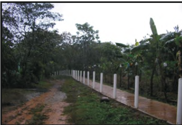
“Construcción de Aceras en Barriada la Cruz”, La Mesa, Corregimiento Cabecera La Mesa, Barriada La Cruz B/.69,999.09
