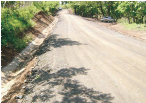
Proyecto 2053. Veraguas, Río de Jesús. Rehabilitación del Camino Río de Jesús Utirá, Fase II
