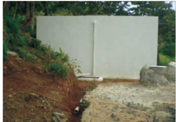
Proyecto 2608. Coclé, La Pintada, Piedras Gordas Construcción del Acueducto de Jujucal
