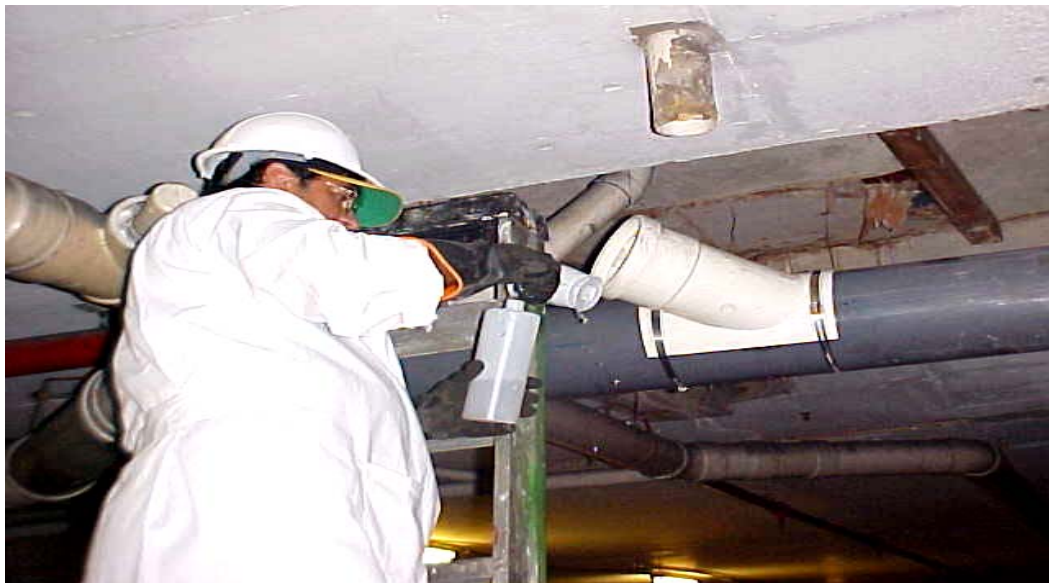
Prueba de Aguas Residuales para el Hotel Marriot
