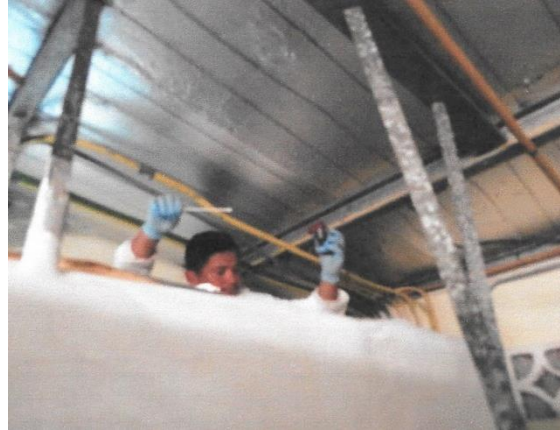
Toma de muestras después de la limpieza de los conductos de aire
