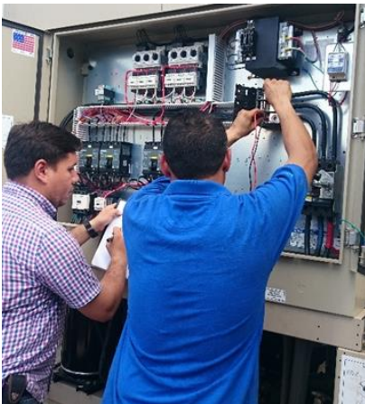
Instalación de la válvula de control de flujo y últimos ajustes, pruebas y arranque inicial.
