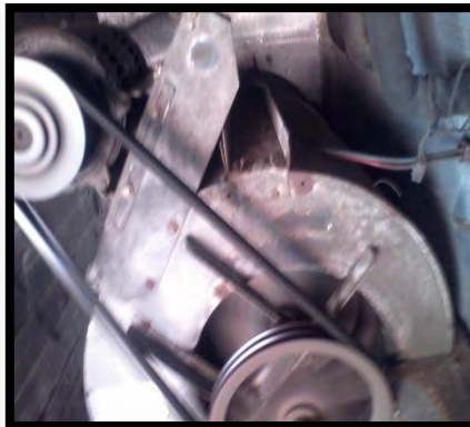
El ventilador consta de dos blower uno se está deteriorando.
