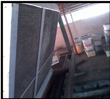
Condensador en mal estado y corroído
