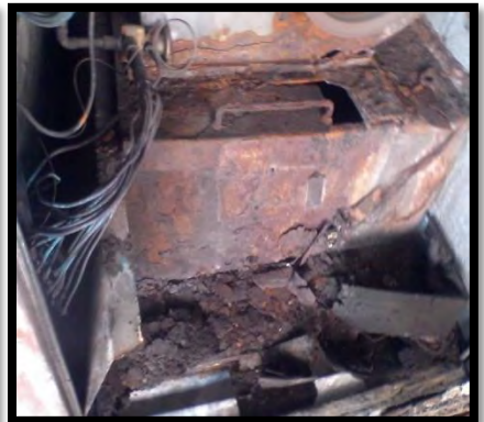
El piso de unidad en mal estado, entra aire caliente.
