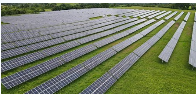
Planta solar en operación – Mayorca, 9.97 MW (Los Santos).
