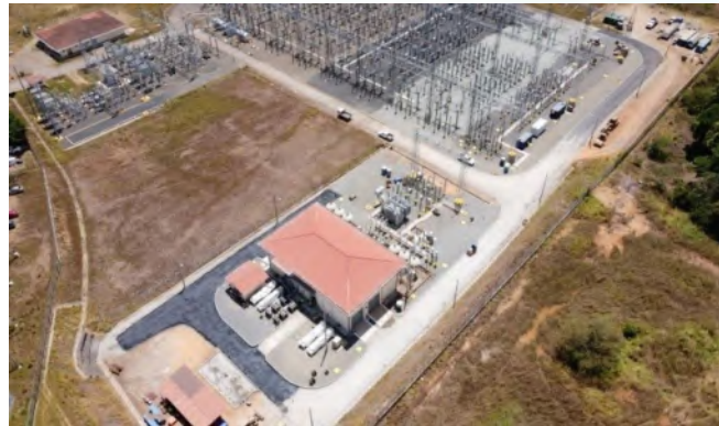
Figura 2. Vista aérea del STATCOM en subestación Llano Sánchez (Casa control de la esquina inferior derecha).
