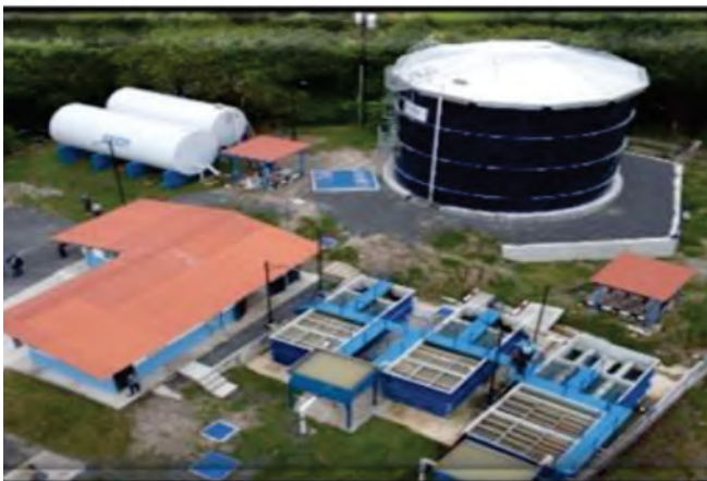
Figura No.4 Ampliación PTAP de San Carlos
