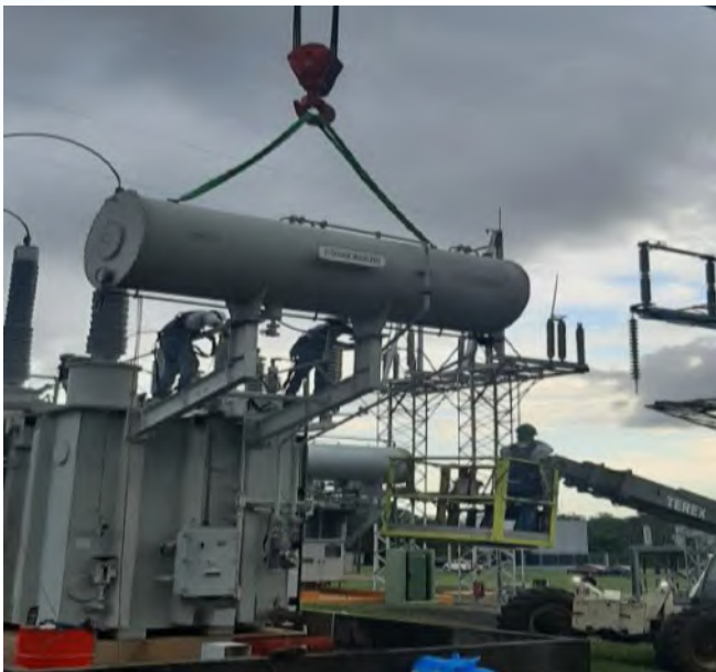
Figura 1. Nuevo autotransformador T1 en la subestación Chorrera.
