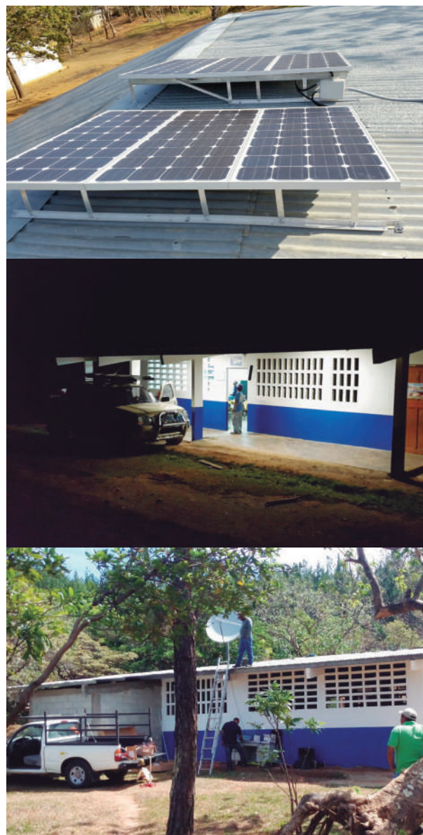
Sistema Fotovoltaico en el C. E. B. G. El Paredón, Región Educativa de Veraguas.
